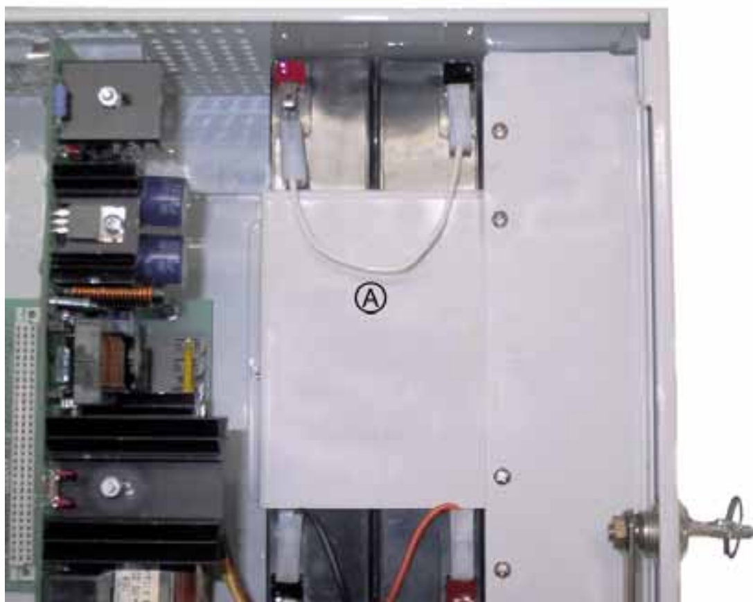
A Alloggiamento batterie
